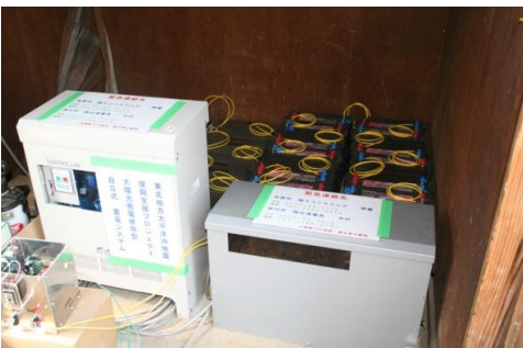
▲蓄電システム”Dパワー”
