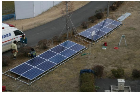
▲太陽光で5.2kwを発電し、蓄電池へ電源を供給する自家発電設備となります。
