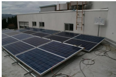
▲太陽光で5.2kwを発電し、蓄電池へ電源を供給する自家発電設備となります。
