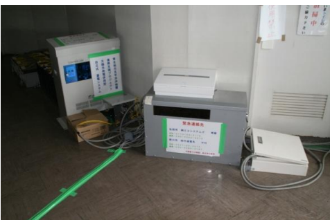
▲蓄電システム”Dパワー”
